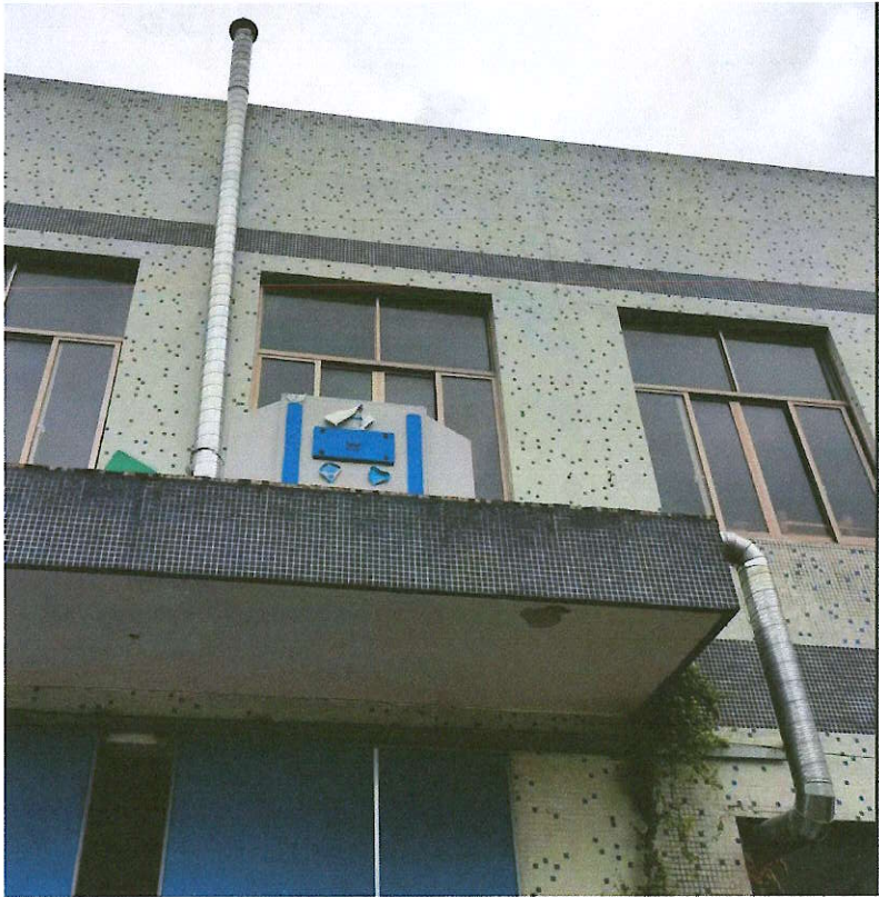
图 3-2 注塑废气处理设施现场照片
